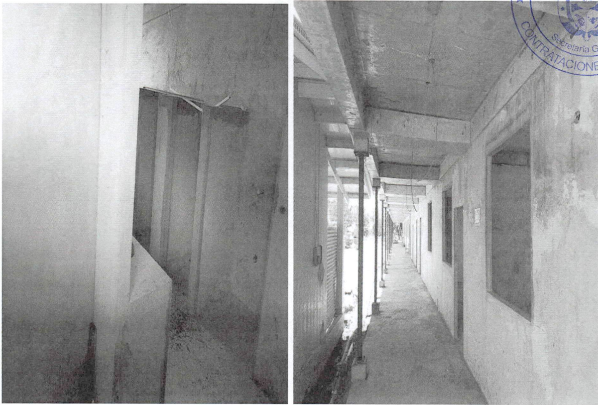
Materiales descompuestos producto de la inacción.
