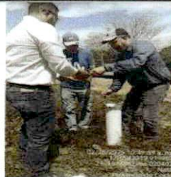
Los Cerritos: pozo con 60mts (196.8pies) de profundidad encamisado con un tubo de PVC de 6 pulgadas
