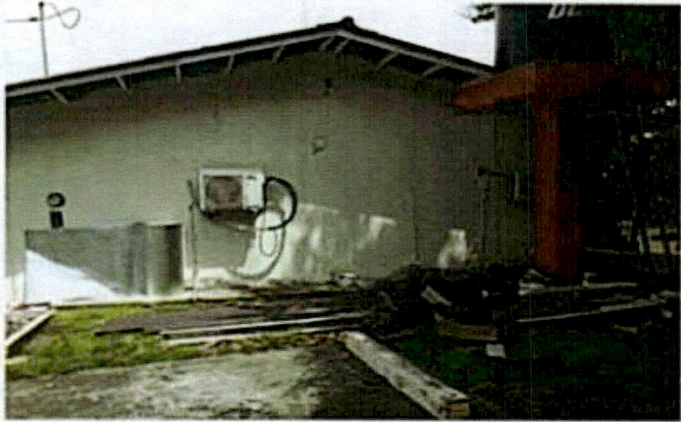
Pendiente la Limpieza General
