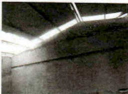
LAMINAS DE ZINC MAL COLOCADAS
