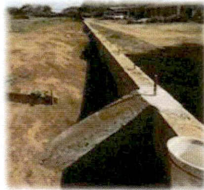
Figura 4. Sección correspondiente a la cerca perimetral. Esta parte de la cerca había colapsado como consecuencia de las inundaciones. Posteriormente fue reconstruida, incorporando una vigueta colocada en un ángulo aproximado de 45 grados.
