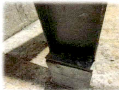
Figura 7. Figura donde se observa la unión de la placa con la columna tipo H, en la cual la soldadura aparenta no haberse ejecutado conforme al procedimiento adecuado. Como propuesta, se recomienda realizar un estudio y ensayo de la soldadura en laboratorio para verificar su calidad y resistencia
